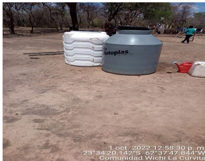
Ilustración 13 Tanques de agua sin conexion
